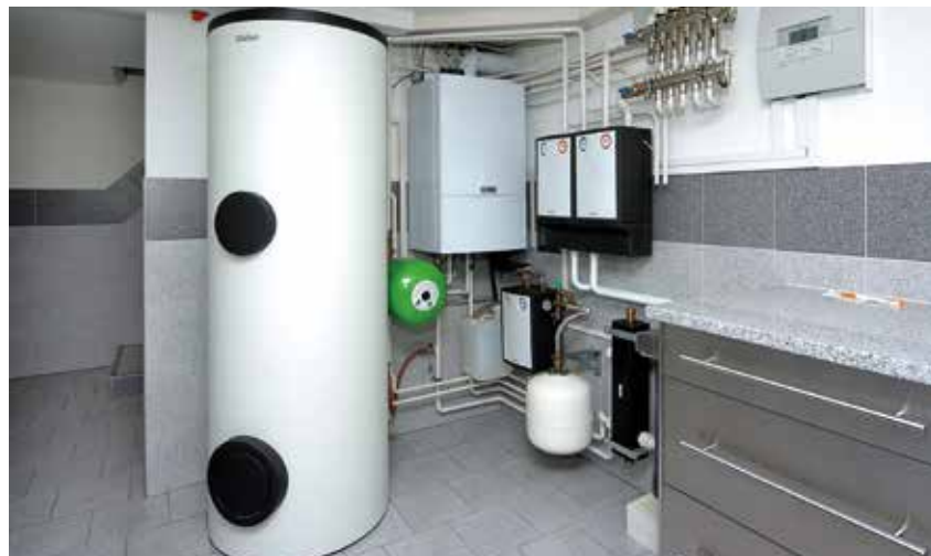
Ordnung und Sauberkeit herrschen hier selbst im Heizungskeller.
