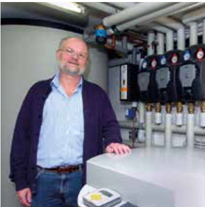
Kostengünstig und umweltschonend: Pelletheizung und Solarthermie.
