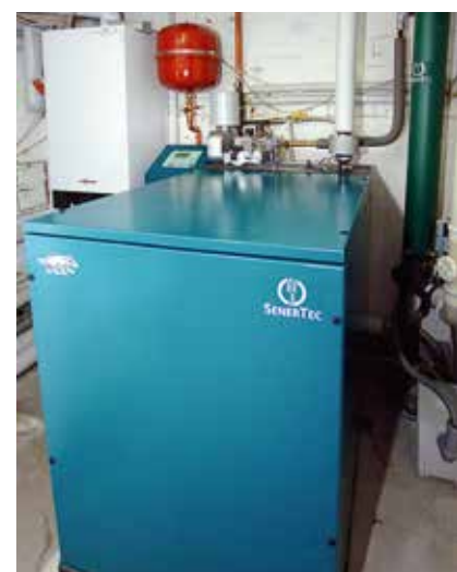
Das BHKW erzeugt gleichzeitig Strom und Wärme.
