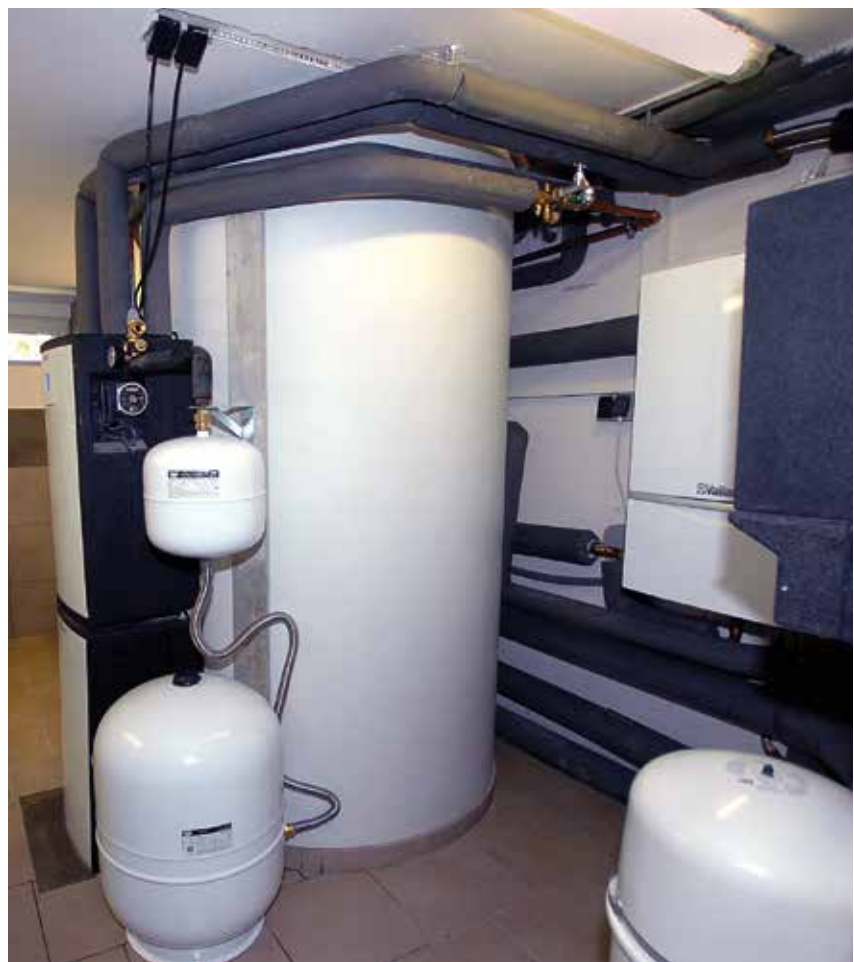
Ein großer Tank speichert die gewonnene Wärme.
